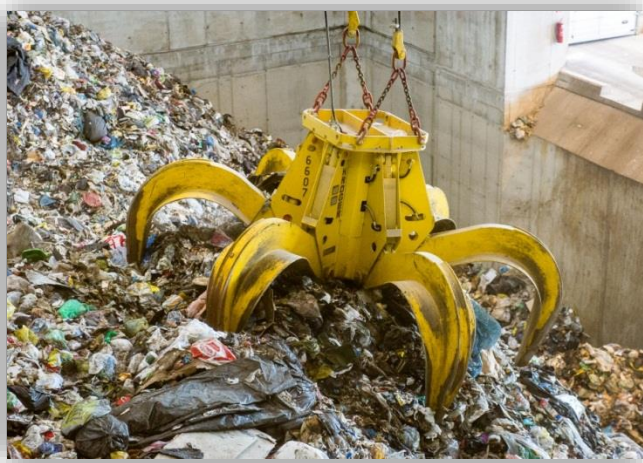
Kuva 2. Jätettä jätebunkkeriin syöttävä kahmari.
