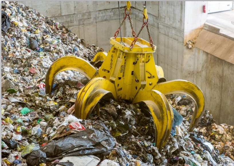
Kuva 1. Jätettä jätebunkkeriin syöttävä kahmari.
