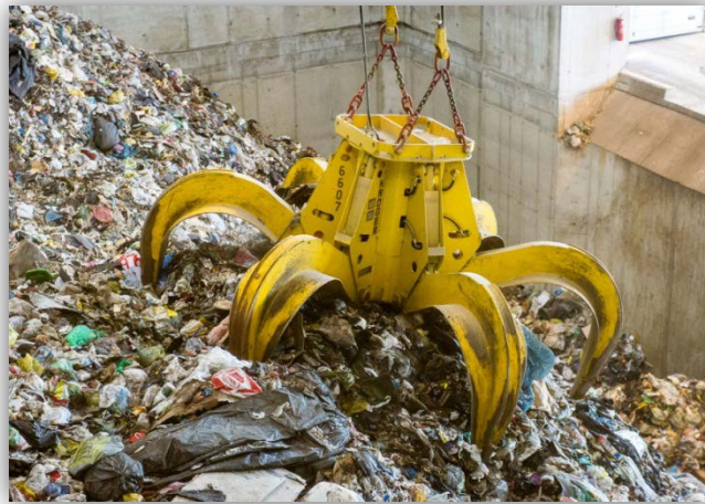
Kuva 2. Jätettä jätebunkkeriin syöttävä kahmari.
